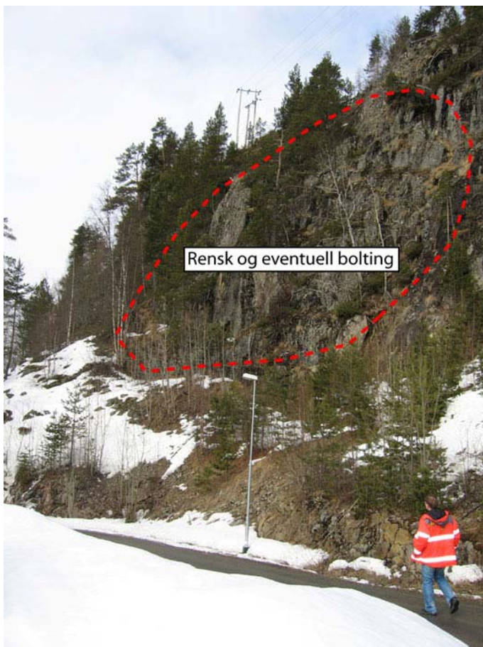
Bilde 3. Området som kan renskes/boltes. Det kan vise seg at det blir tilstrekkelig sikring og at man ikke trenger rasgjerdet i underkant av dette området.
