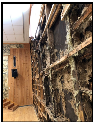
Råteskader i Rauland festsal
